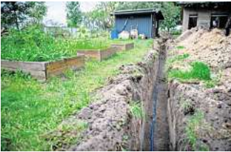
Vorsicht bei Tiefbauarbeiten! Foto: Zacharie Scheurer/dpa
