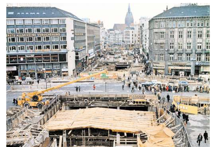
Die Bahnhofstraße Richtung Kröpcke im Jahr 1974: In der Baugrupe entstehen U-Bahn-Haltestelle und die Passerelle.
