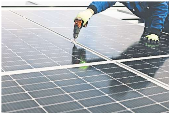
Für Photovoltaikanlagen auf Bestandsdächern gibt es in Hannover verbesserte Förderbedingungen. Symbolfoto: Markus Spiske / Pexels
