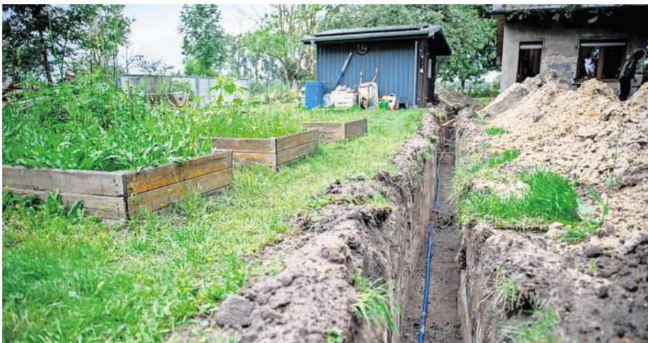
Vorsicht bei Tiefbauarbeiten! Foto: Zacharie Scheurer/dpa
