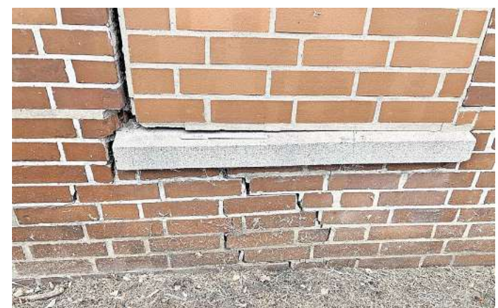
Größer werdende Gebäuderisse und Fensterfugen: Die Fotos zeigen den Zustand der Alten Penne im September. Foto: Stadt Laatzen
