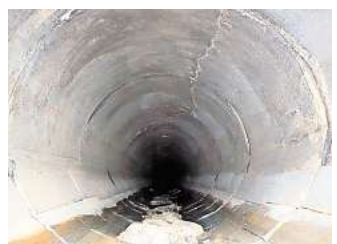
So sieht es unter der Straßendecke aus: Marode Kanäle in Hemmingen. Foto: BPI Hannover/Stadt Hemmingen
