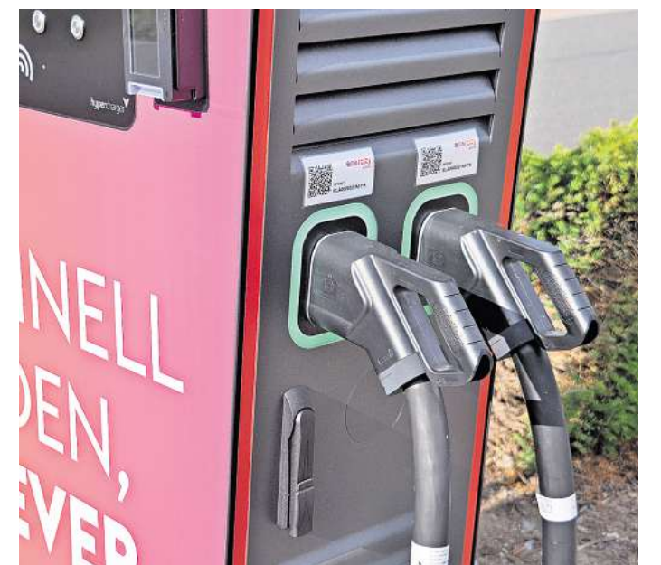
Die neue Ladesäule verfügt über zwei 150-kW-Anschlüsse.
