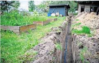
Vorsicht bei Tiefbauarbeiten! Foto: Zacharie Scheurer/dpa
