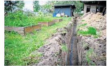
Vorsicht bei Tiefbauarbeiten! Foto: Zacharie Scheurer/dpa
