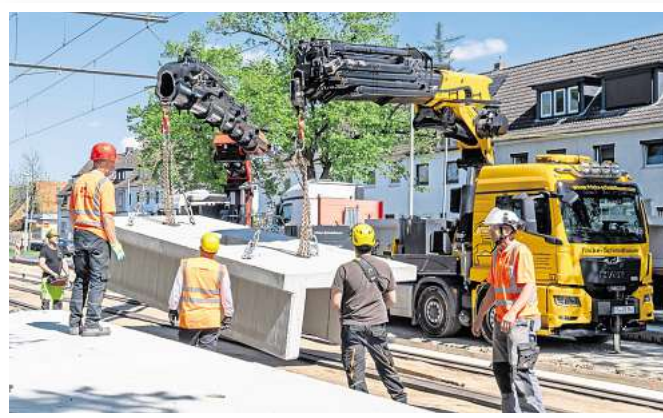
Mehr Hochbahnsteige: In Bothfeld errichten Arbeiter den nächsten barrierefreien Zugang für die Stadtbahn. Foto: Tobias Woelki
