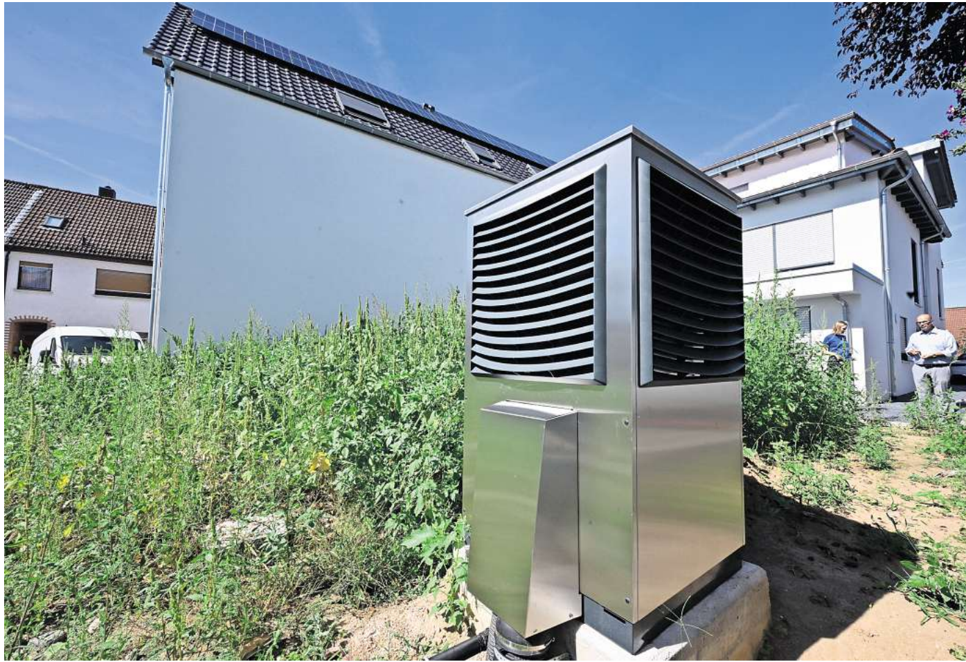
Eine Wärmepumpe, die mehrere Nachbarn sich teilen? Das wäre eine Option, so Bürgermeister Jan Dingeldey.
