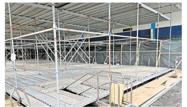
Kaum wiederzuerkennen: Die Empore im Hallenbadbereich ist schon verschwunden. Im Becken steht ein großes Gerüst.
